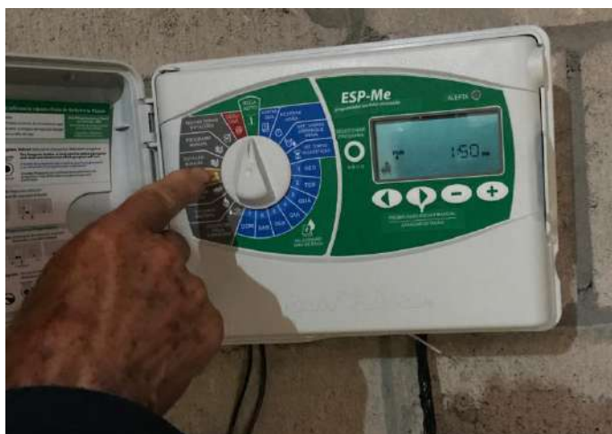
Controlador do sistema de irrigação
