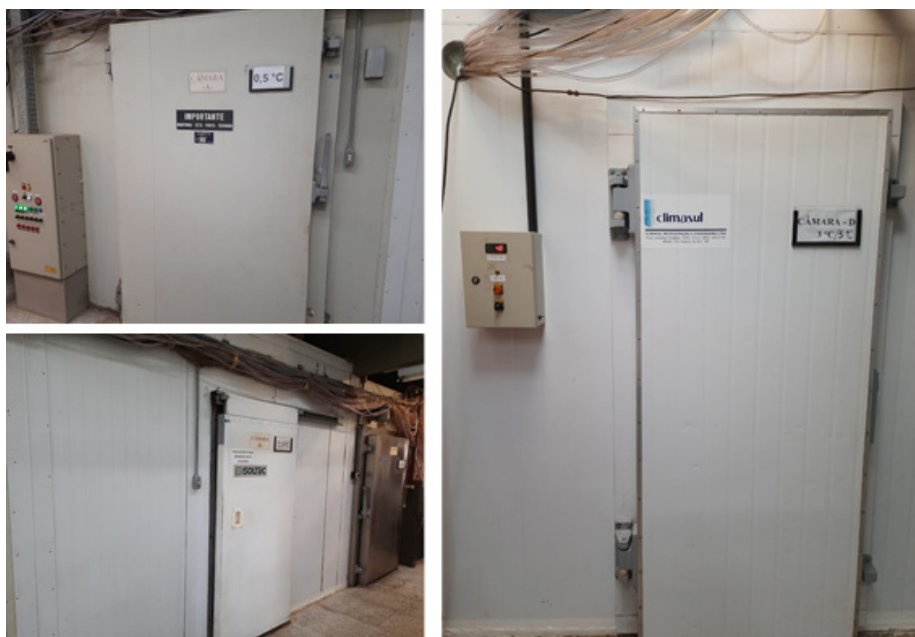
Figura 2: câmaras frigoríficas para o armazenamento de pecans em temperatura reduzida
